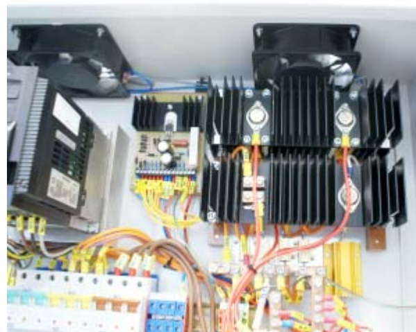
Obr.20 Chladicí ventilátory v rozvaděči (V2 nad sadou chladičů tranzistorů)
