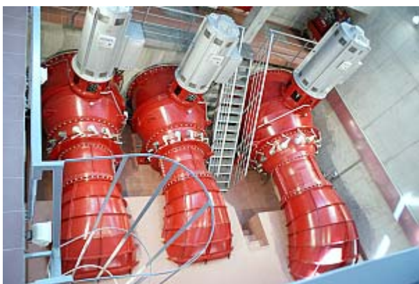
Obr.37 Strojovna MVE Železný Brod
