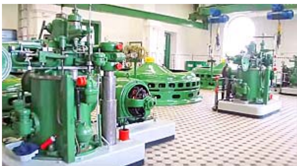
Obr.8 Strojovna MVE Hučák
