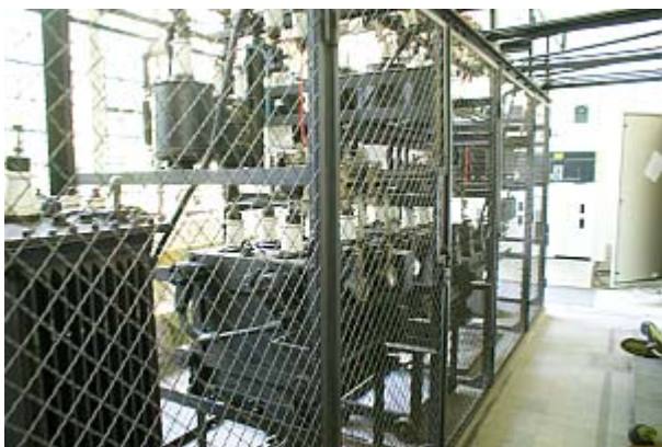
Obr.42 Původní klecová rozvodna 5,5/10 kV V pozadí nová skříňová rozvodna 10 kV.
