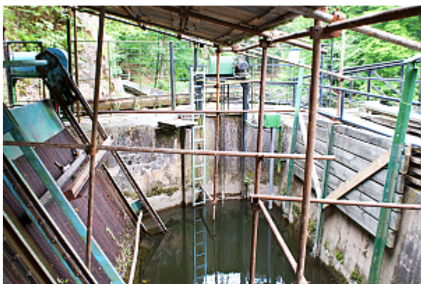
Obr.22 Česle vtokového objektu
