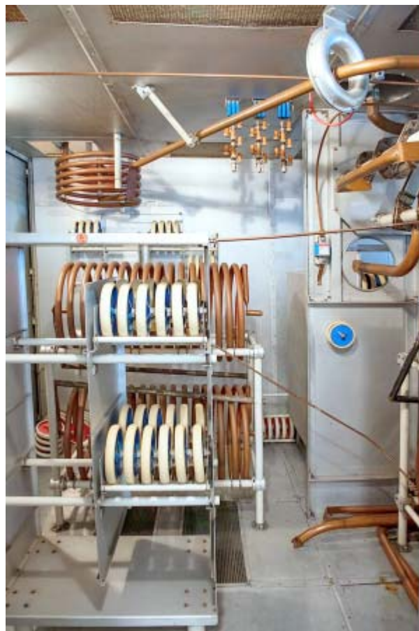
Obr.12 Vnitřní prostory vysílače TESLA DRV 750 [3]
