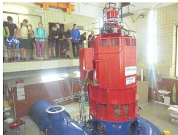
Obr.29 Nové soustrojí 1 MVA s Kaplanovou turbínou v MVE Myší díra v Liticích nad Orlicí
