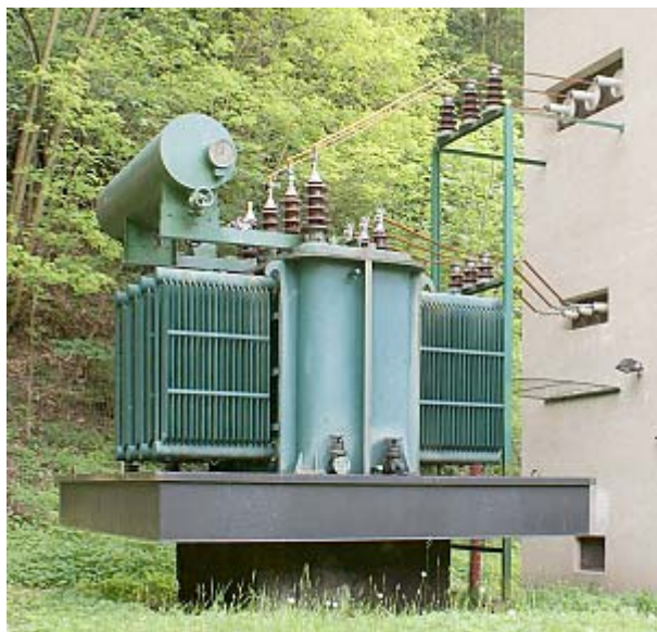
Obr.26 Transformátor elektrárny v ochranné olejové vaně
