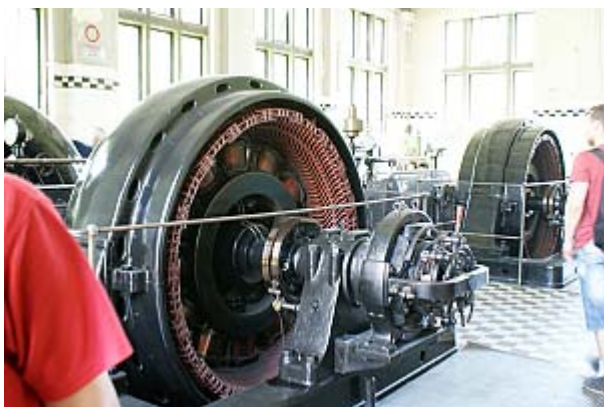
Obr.40 Generátory v MVE Popelnice 2 × 420 kVA/5,75 kV/500 ot/min
