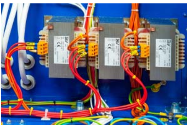
Obr.5 Redukční autotransformátory 400/230 V
