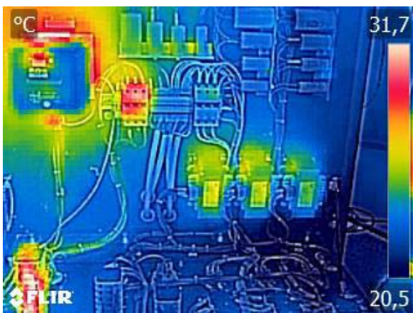
Obr.40 Termosnímek vnitřku rozvaděče
