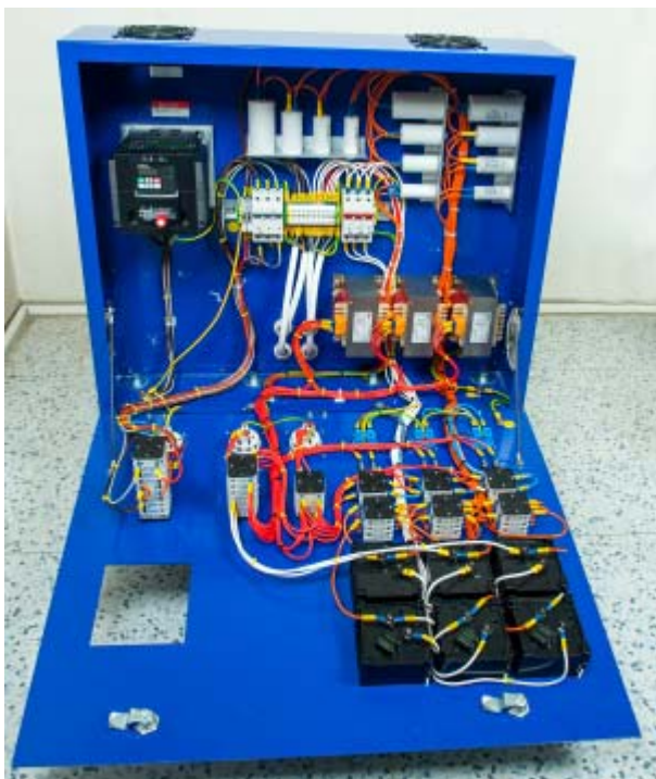
Obr.4 Otevřený rozvaděč RMG16
